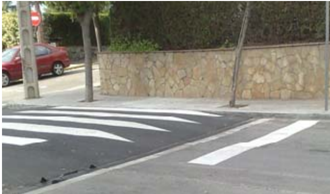
Paseo de las Oliveras: Paso peatonal de baja calidad rehecho varias veces y mal acabado.
