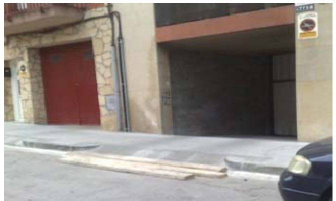
Av. Montserrat: Acera mal construida, rozan los bajos de los coches al salir de parking. Reparada 4 veces y sigue.
