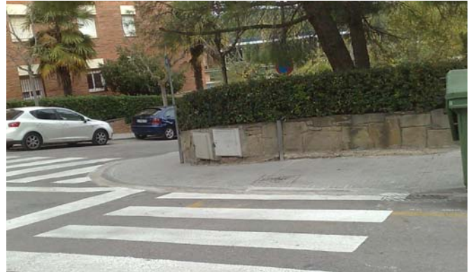
Av.Montserat - Calle Fusalba: Acera mal construida, cuando llueve el agua sube por encima de la acera hasta los jardines.
